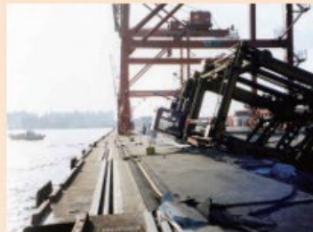
兵庫県南部地震の被害
